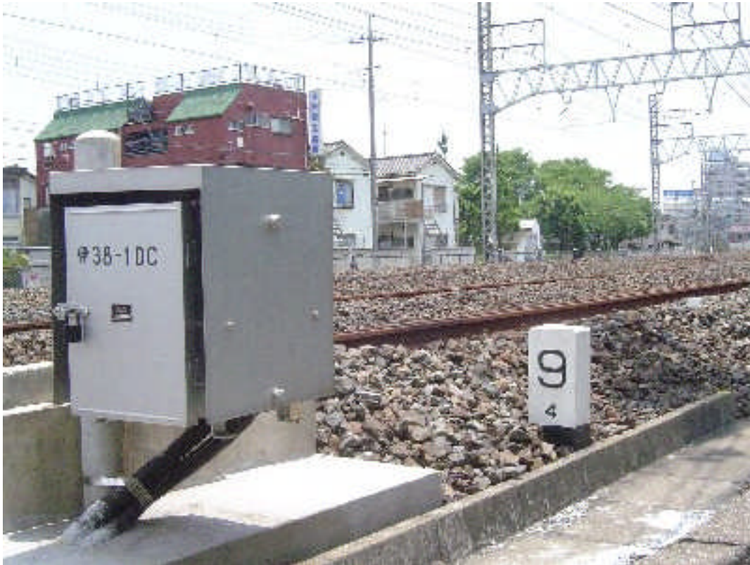
第38号踏切下り急行線警報開始用の踏切制御子機器箱 (北千住起点4K900M付近。右奥は西新井駅)
