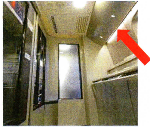
図5 喫煙ルーム内上部の吸込み口
