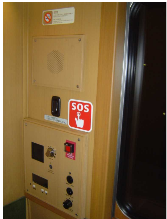
車いす対応個室の非常通報器 左上の写真で左奥方向の枕元部分にある
