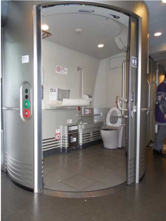
N700系11号車の多機能トイレ （ベビーチェア・ベビーベッド有り） ！天井の火炎感知器にも注目
