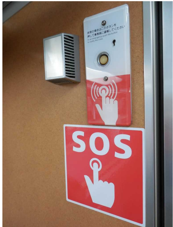
南海電鉄31000系「こうや」の 車いすスペース付近の非常通報ボタン 取り付け位置が高いため 車いすの人は手が届かない
