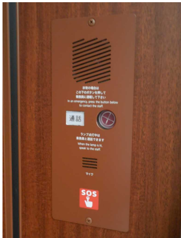
左の写真の車いすスペース部分にある 非常通話装置
