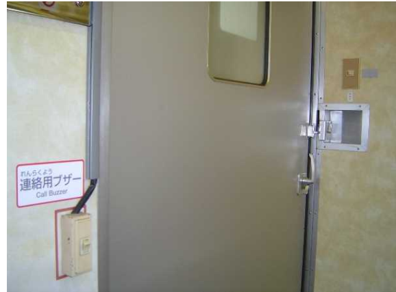
多目的室の内部に設置された 非常連絡用ブザー
