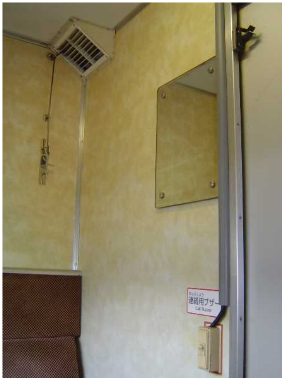
多目的室の内部の空調吹き出し口 風量調整用の紐も見える
