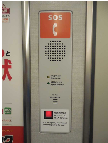
N700Sの11号車の 非常通話装置
