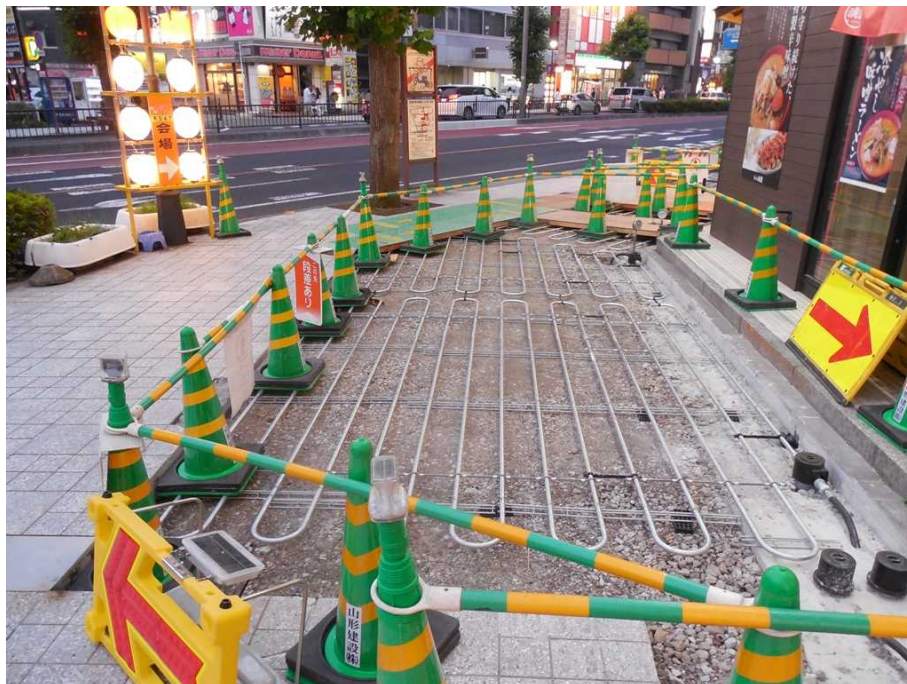
【参考】山形駅前の歩道で見かけた、地下水を利用した融雪設備の修繕工事現場。国道112号線の自転車道にも、これと同じ物が埋設されている。 （この写真のみ2024年7月13日（土曜日）の日没頃に撮影）
